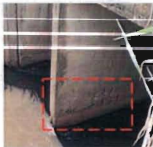
Dano superficial no concreto com exposição de armadura.
