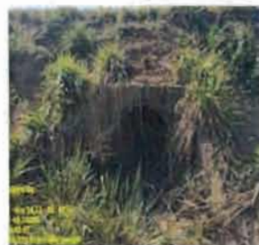
Presença de vegetação ocupando entre 50% e 100% da área da soleira.
