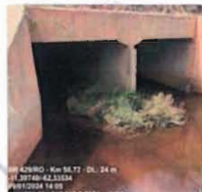
Presença de vegetação ocupando até 50% da área da soleira.
