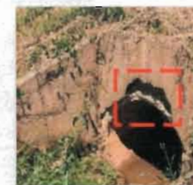
Elemento quebrado com perda até 25% do volume do elemento.
