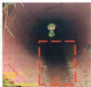
Corrosão em processo inicial.
