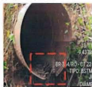
Corrosão com perda de seção de material.
