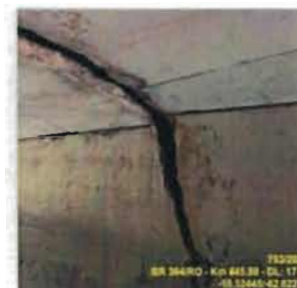
Rachaduras com abertura acima de 1 cm.
