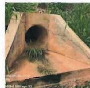
Fissuras e trincas com abertura de até 1 cm.
