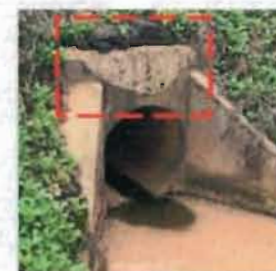
Elemento quebrado com perda de até 70% do volume do elemento.
